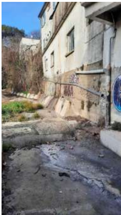
ZAE - pollution d'un cadereau pluvial bétonné
