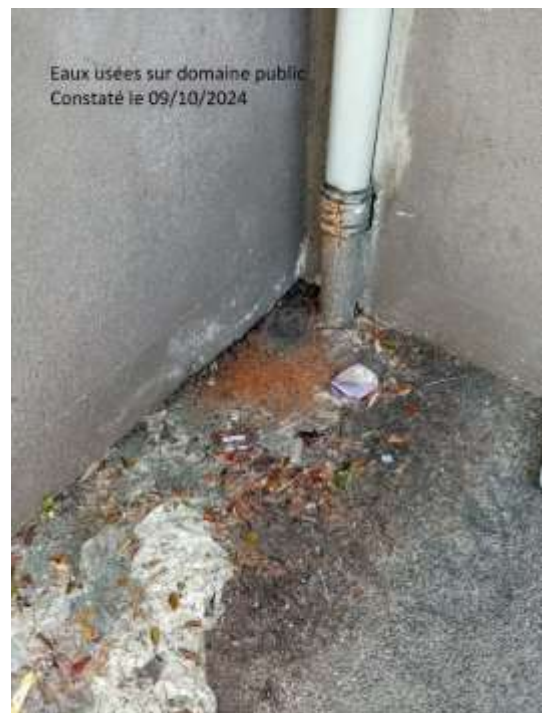
Rejet illicite d'eaux usées sur domaine public
